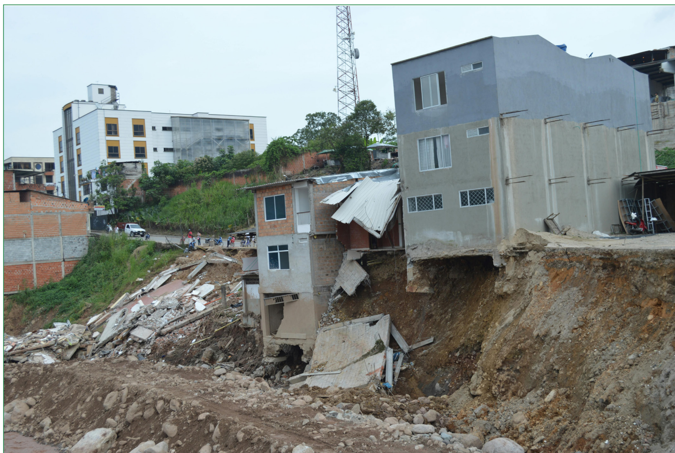
Figura 1 – Deslizamento de terra
